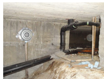
F.5 Ventilateur radial-centrifuge intégré dans la paroi du vide sanitaire
