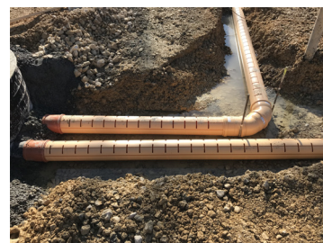
F.7 Coude dans un drainage mixte radon/eau en PP
