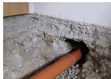
F.6 Sortie du tuyau de drainage
