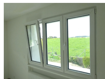
Ventilation par ouverture manuelle des fenêtres
