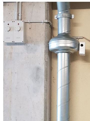
F.6 Conduite extérieure et ventilateur
