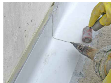
F.2 Joint de reprise de bétonnage
