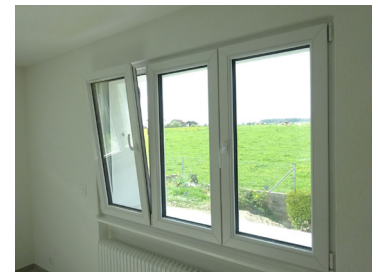
Ventilation par ouverture manuelle des fenêtres
