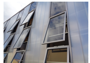
Fenêtre à ouverture automatique
