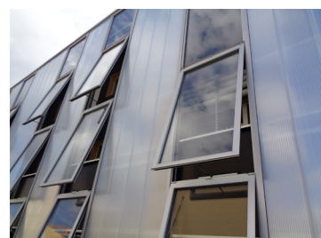
Fenêtre à ouverture automatique
