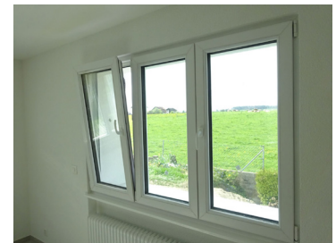
Ventilation par ouverture manuelle des fenêtres
