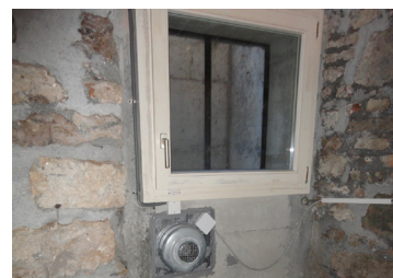
F.4 Ventilateur intégré au mur et prise de courant dans le puits de lumière
