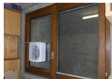
F.5 Ventilateur dans la vitre de la fenêtre
