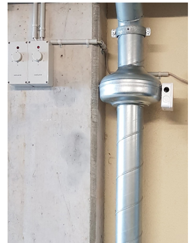
F.6 Aktiver Kamin, Aussenkanal und Ventilator
