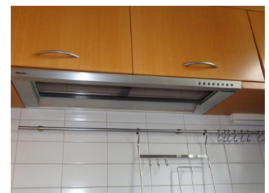
F.9 Dampfabzugshaube in einer Küche
