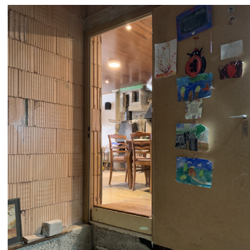
F.3 Undichte Tür
