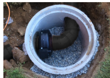
F.7 Schacht zur Wartung des Ventilators
