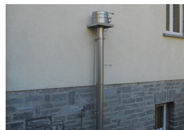
F.8 Verlängerung der Rohrleitung zur Abführung der radonbelasteten Luft
