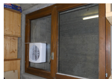
F.5 Ventilatore inserito nel vetro della finestra
