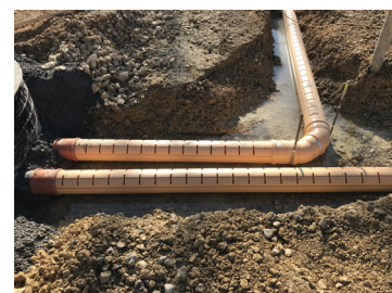
F.7 Curva a gomito in un drenaggio misto radon/acqua
