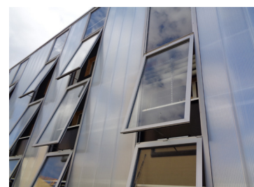
Finestre ad apertura automatica
