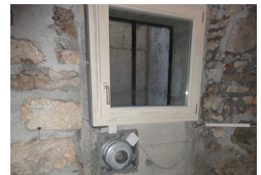
F.4 Ventilatore inserito nella parete e uscita nel pozzo luce
