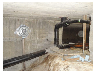
F.5 Ventilatore radiale-centrifugo inserito nella parete del vespaio
