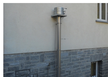
F.8 Prolungamento della condotta per l'espulsione dell'aria contaminata
